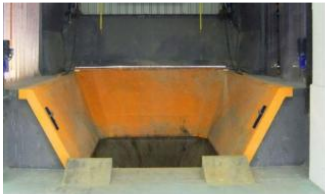
图 1.8-2 生活卸料溜槽实景图
