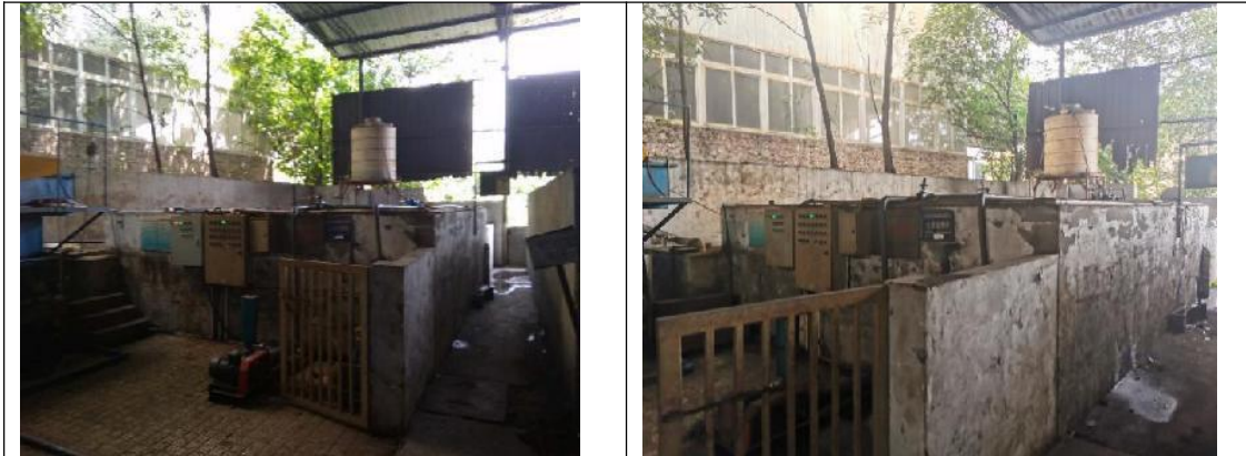
图 2.6-2 废水处理站照片
