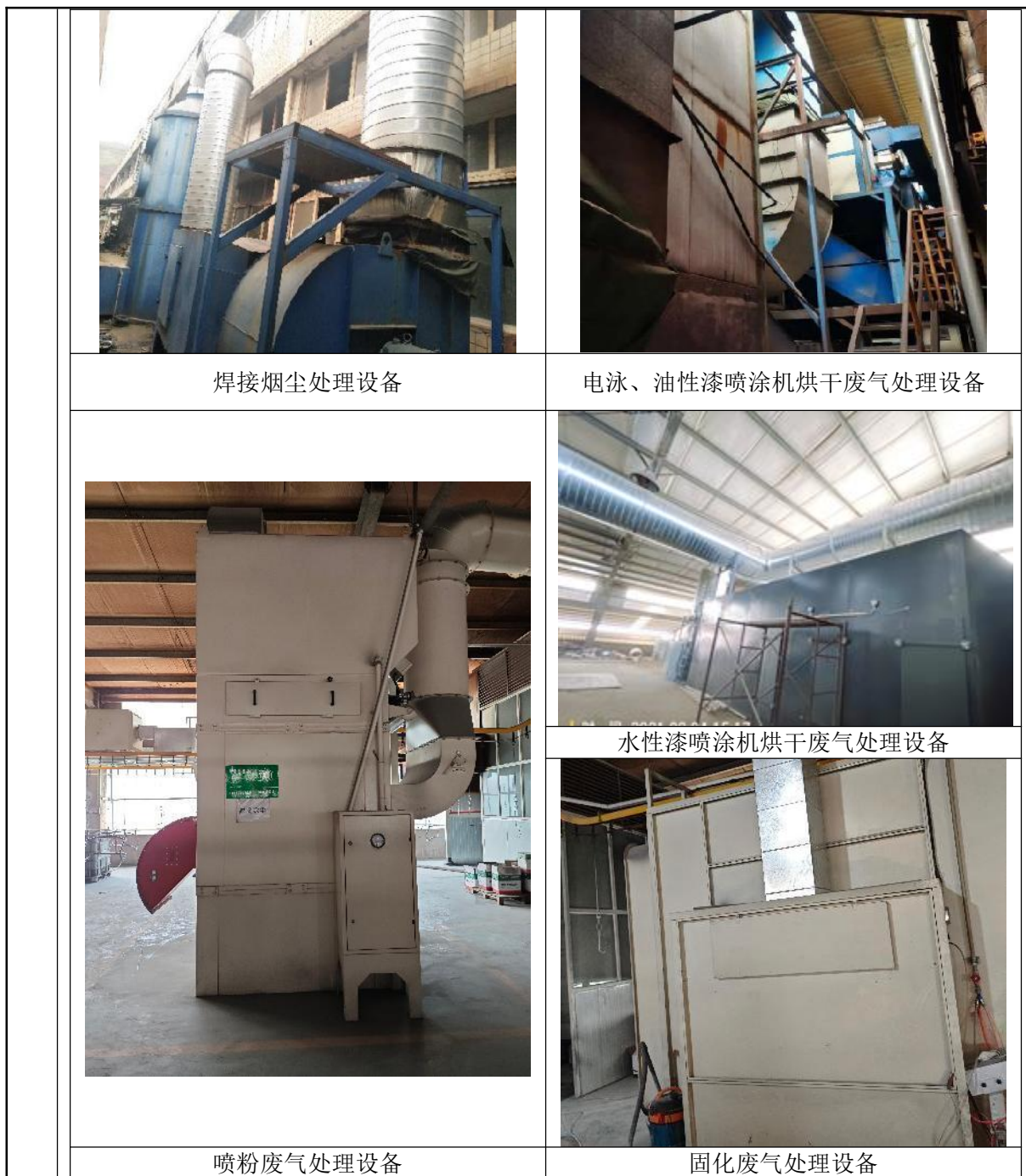
图 2.6-1 废气处理设施
